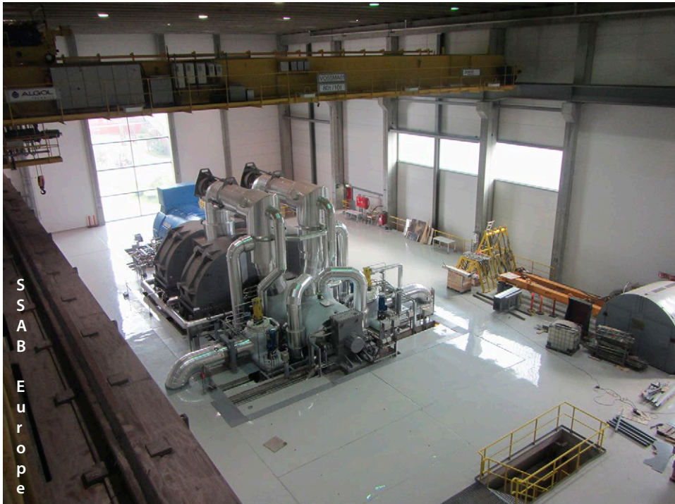
SSAB:n Raahan terästehtaan uuden voimalaitoksen turbiinihalli.
